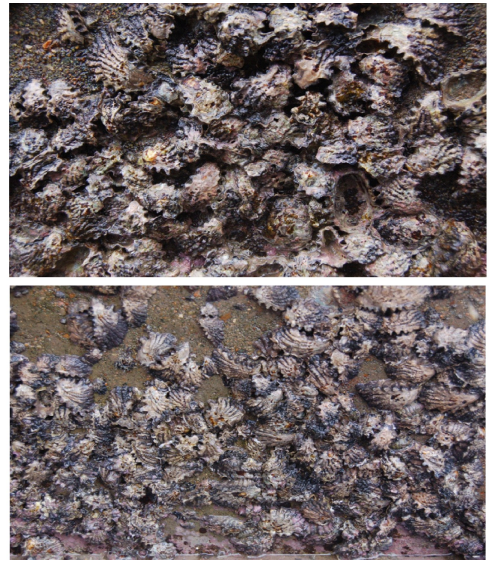
图 6 实验平台下部水泥面潮差区污损生物
